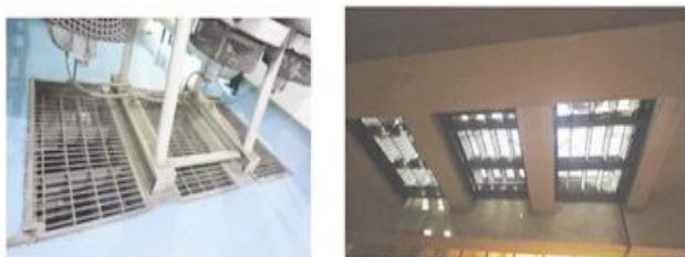
图 1 主变室格栅及格栅下部空间
